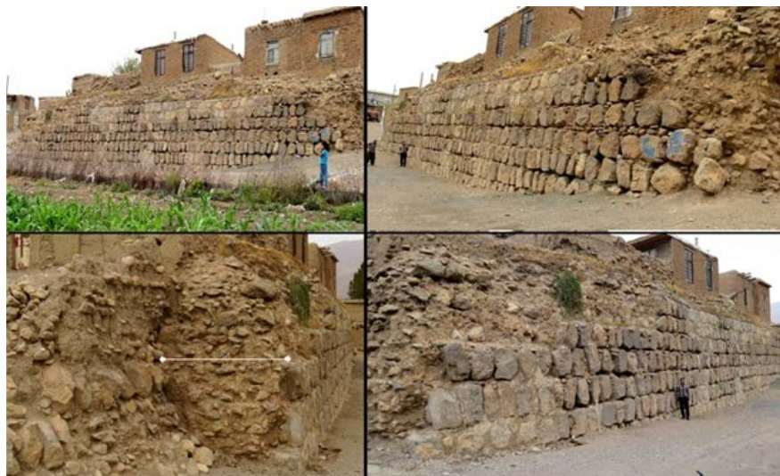
► تصویر ۵. دیواره‌ی جنوبی، دید از جهات متفاوت (پایین سمت چپ: ضخامت دیواره‌ی جنوبی)، (نگارندگان، ۱۳۹۴).
