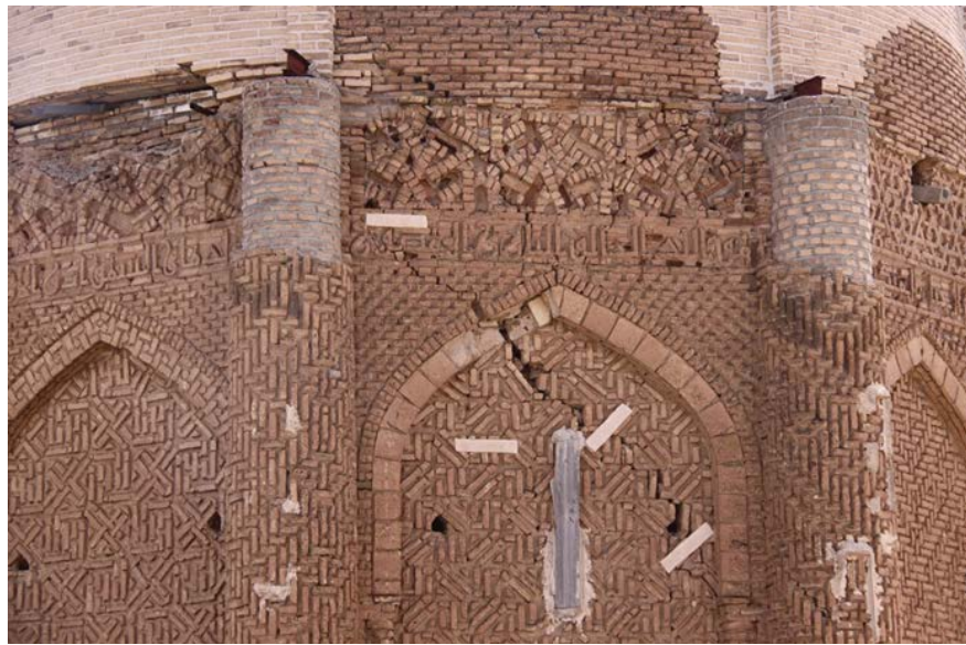
► تصویر ۱۰. برج شرقی خرقان، بخش‌های از کتیبه‌ی قرآنی و آسیب‌دیدگی‌های بنا (عکاس: ابراهیم صادقی، ۱۳۹۴).
