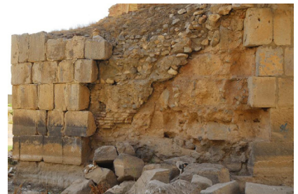
▲ تصویر ۸. نمای غربی آب‌شکن شمالی پایه ششم پل که مرمت‌های دوره‌های مختلف را نشان می‌دهد (عکس از: پایگانی پایگاه میراث جهانی بیستون، عکاس: بابک صدیقی).
